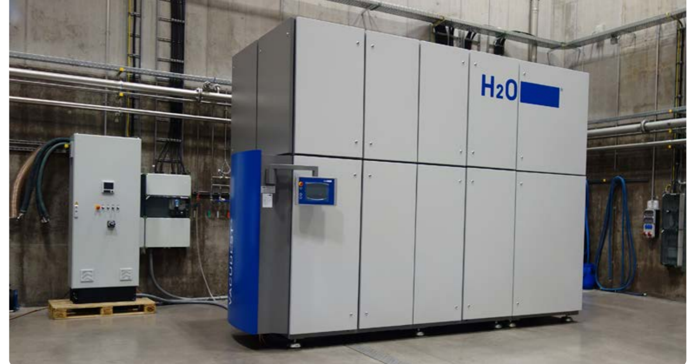
Die ersten VACUDEST Systeme mit Purecat Modul sind erfolgreich bei unseren Kunden installiert
